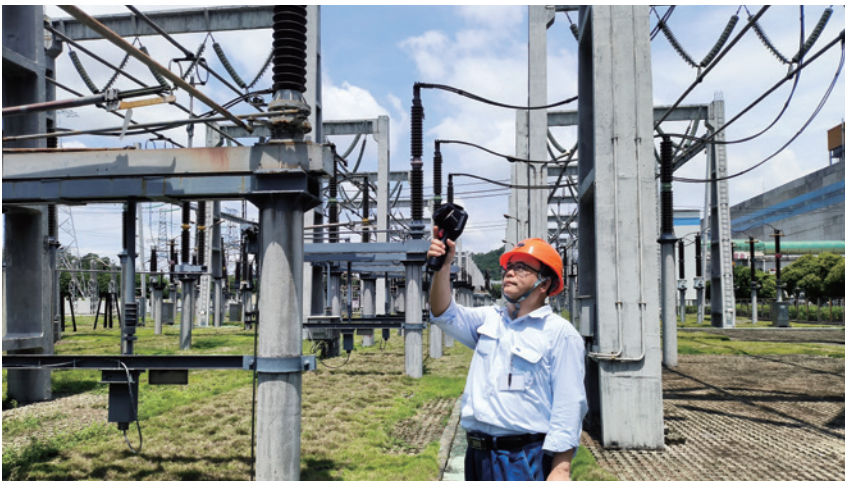
值班员巡视升压站运行情况。
