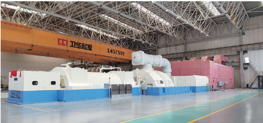
8月30日，珠江LNG电厂二期项目1号机组首次并网一次成功。
